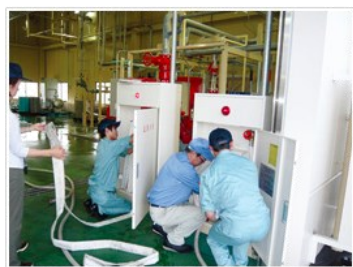
- 屋内消火栓操作体験 -
